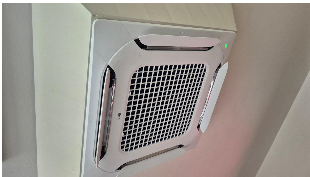
Obrázek 20: Obchod – klimatizační jednotka
