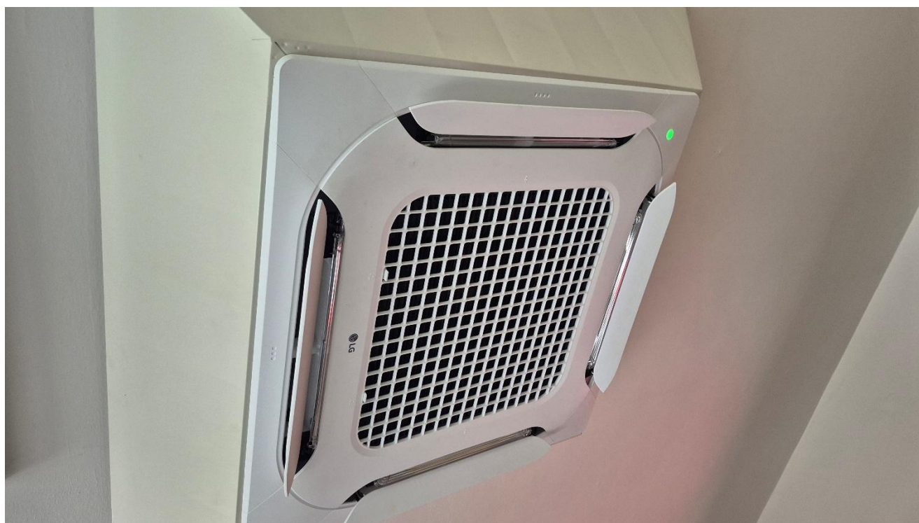
Obrázek 13: Obchod – klimatizační jednotka
